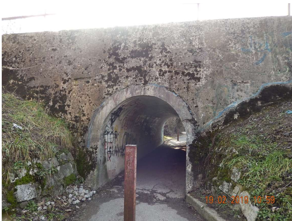
Slika 2: Pogled na drugo stran objekta. Na tej strani so krilni zidovi betonski, kar daje slutiti, da je bil hkrati s sanacijo loka izvedeno tudi podaljšanje objekta.
